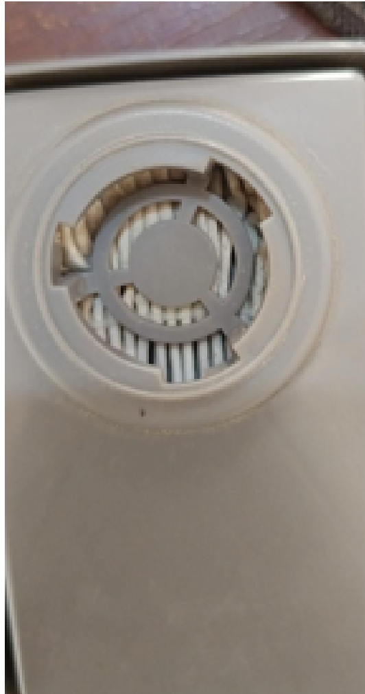
FILTRO SATURADO HUMEDAD – REQUIERE CAMBIO
