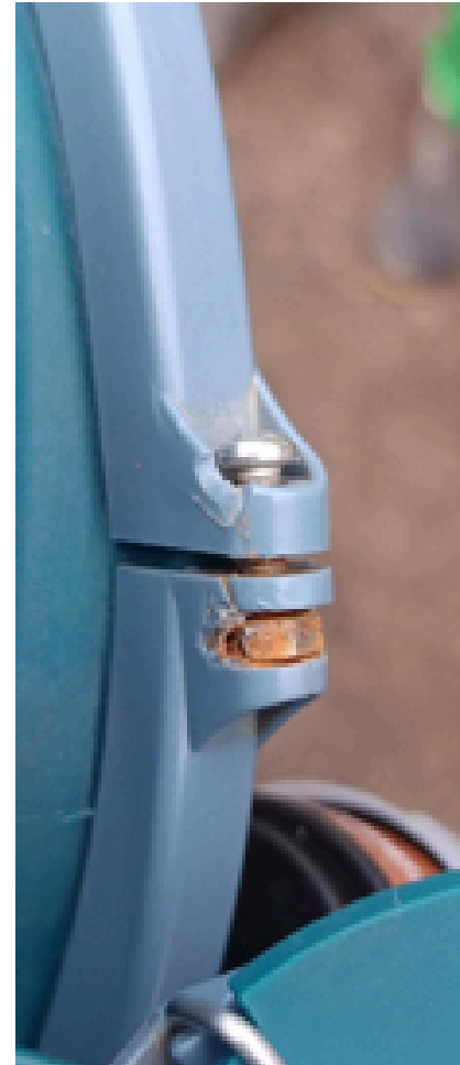
TORNILLO CON PRESENCIA DE OXIDACION – MARCO ANTIGUO – REQUIERE
